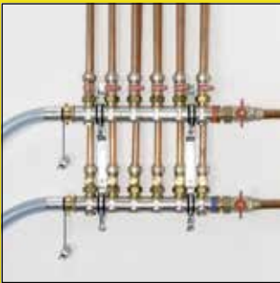
Preplachovanie radiátorov a plošných vykurovacích systémov (S/SL/SLW)
